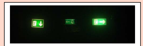
Rettungszeichenleuchten unterschiedlicher Qualität im Brandrauch
